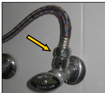
Figura 7: Punto de instalación de un restrictor en el flexible de una llave de lavamanos
